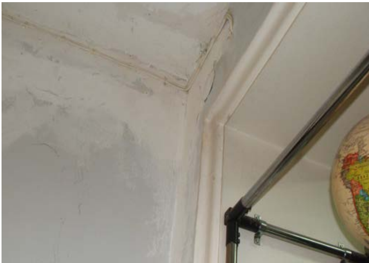
Fot. 13. Sala ekspozycyjna. Zniszczenia efektem nieszczelności dachu i przemarzania stropu
