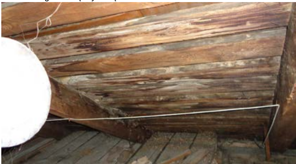
Fot. 16. Zawilgocenia poszycia dachu nad lukarną
