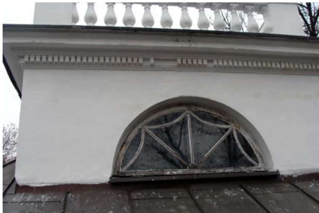
Fot. 12. Uszkodzenia gzymsu wieńczącego „belwederek”
