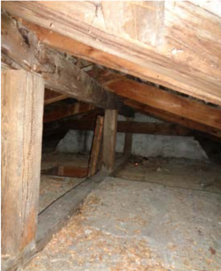
Fot. 19. Dach D – widoczne zniszczenie fragmentu krokwi kalkinowej
