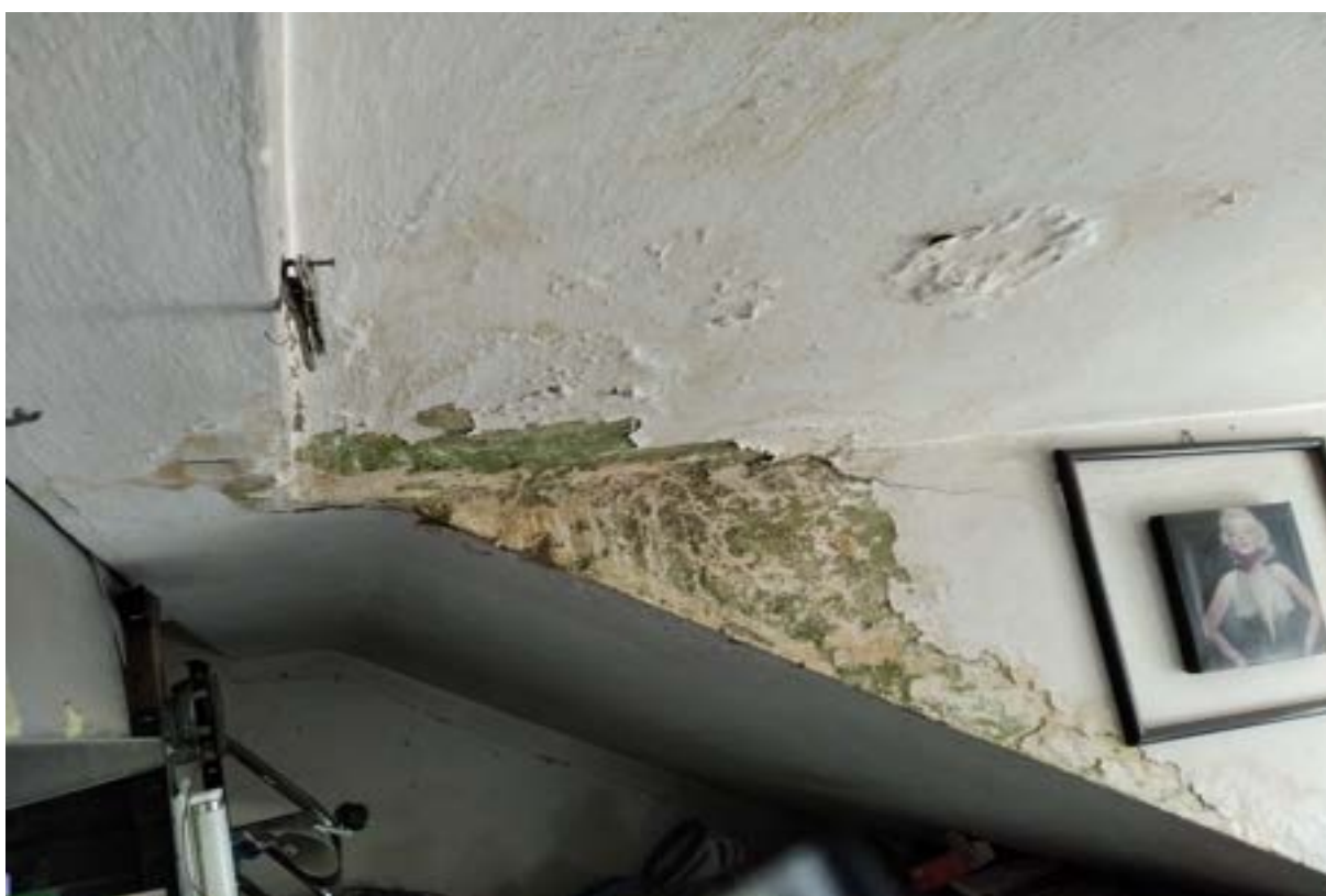
Fot. 14. Zawilgocenie ścian i sufitu wnętrza lukarny w pracowni muzealnej
