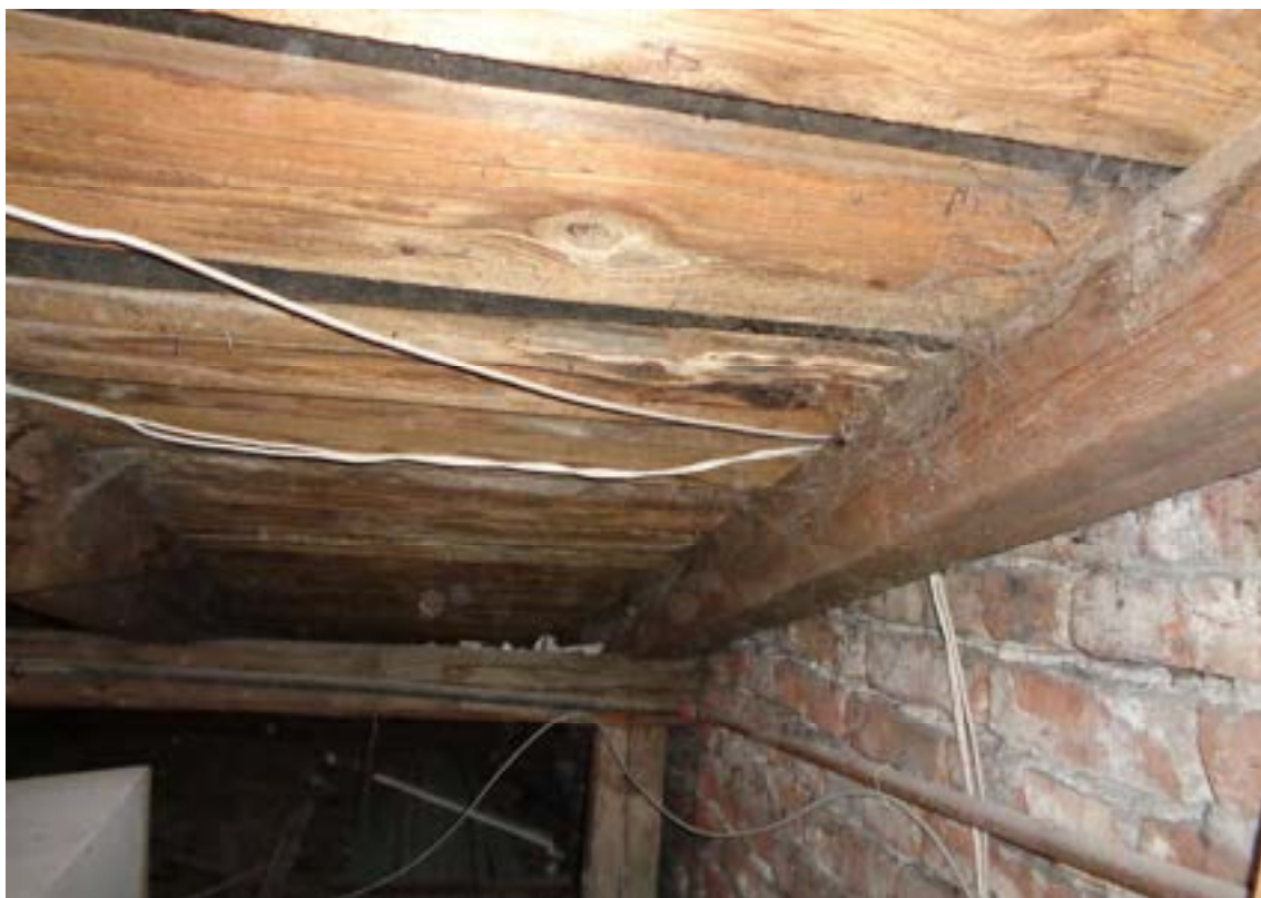
Fot. 29. Dach G – zawilgocenia deskowania i krokwi
