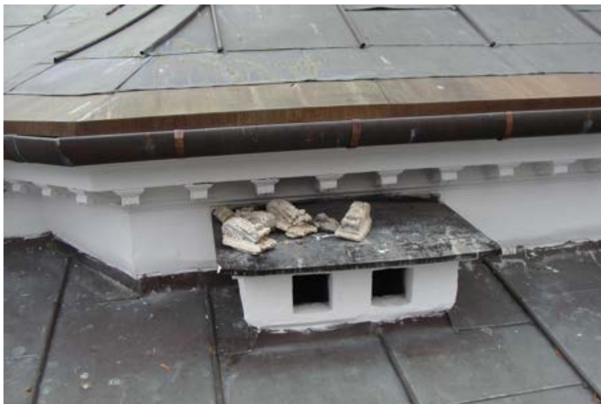
Fot. 11. Zniszczenia elementów sztukatorskich (kroksztynki) gzymsu wieńczącego
